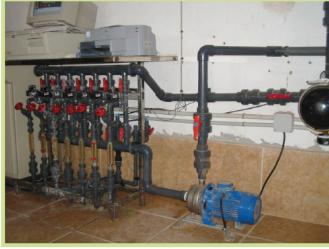
شكل 25: منظومة الحقن مكونة من 7 آلات الفونترى تعمل بواسطة مضخة كهربائية
